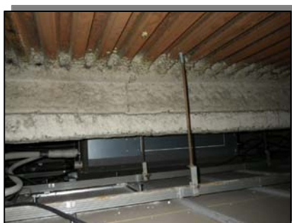
吹付アスベスト
