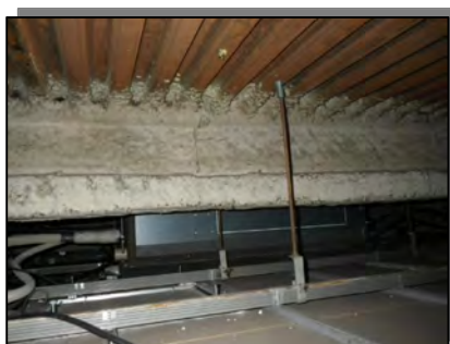
吹付アスベスト
